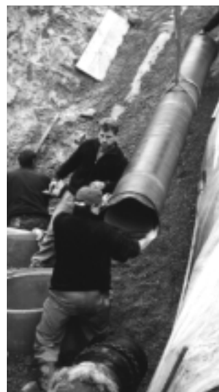
Le réseau de distribution suisse compte près de 50'000 km de conduites
